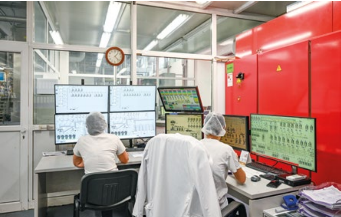
КОНТРОЛНА ЗАЛА НА ЛИНИЯТА ЗА ПРОИЗВОДСТВО НА ШОКОЛАДОВИ МАСИ Източник: Фирмен архив
